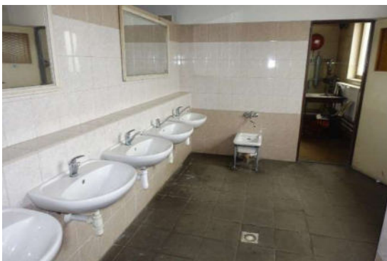
Soc. zařízení v hale na st.p.č. 61
